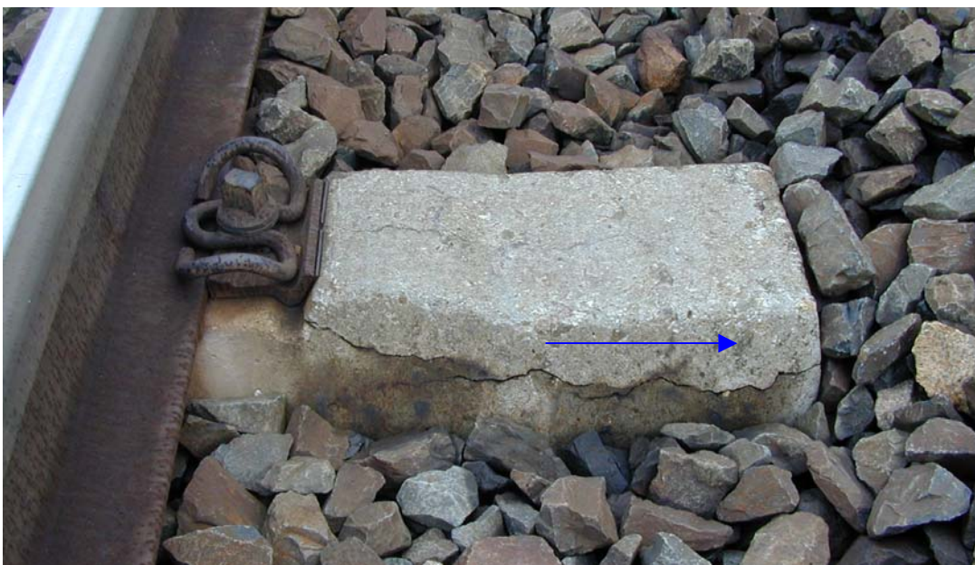
Bild 4 Riss „durchgehend“, Gefährdung der Spurhaltung, Schadenklasse 1
