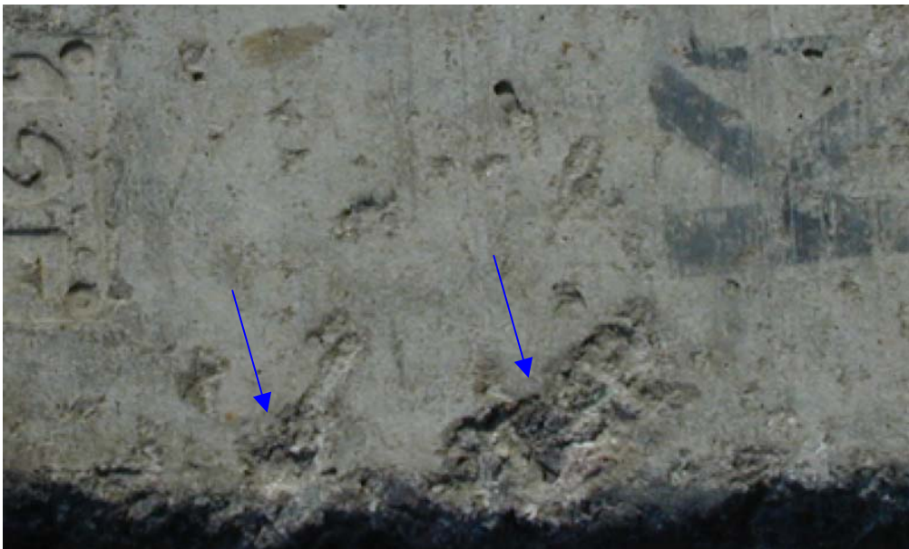
Bild 15 Kantenausbrüche durch mechan. Einwirkung, Schadenklasse 3
