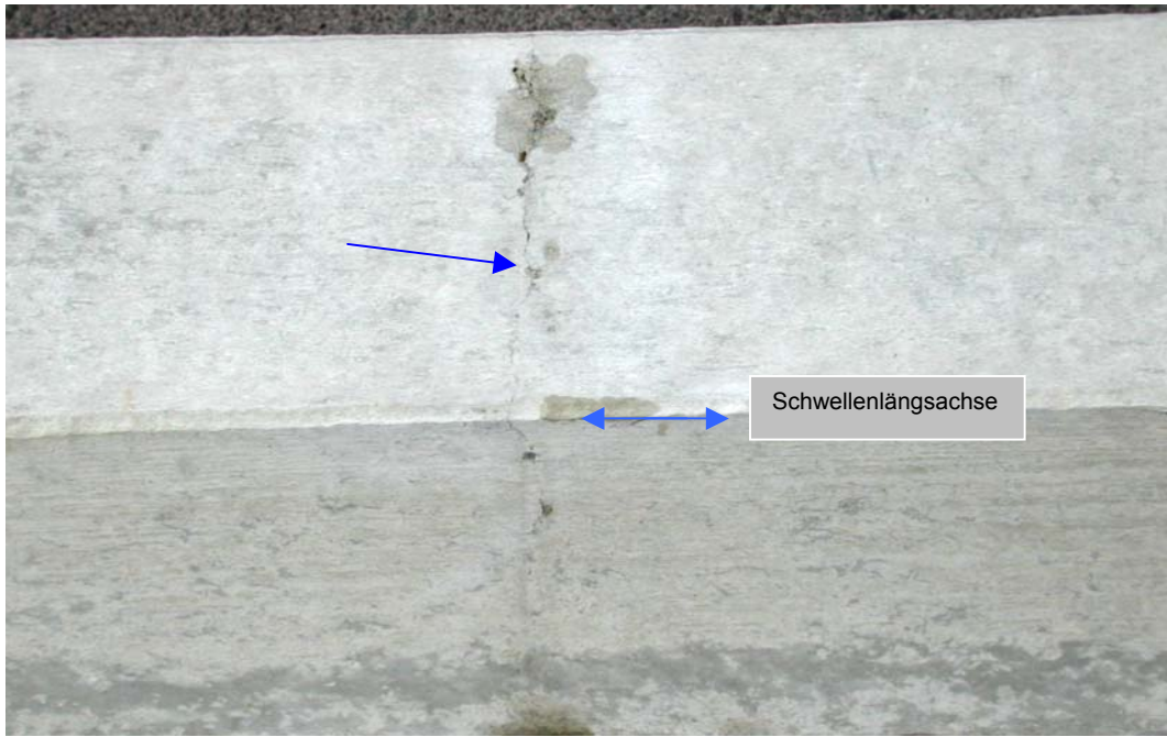
Bild 5 Riss (Biegeriss), geschlossen, Schadenklasse 3
