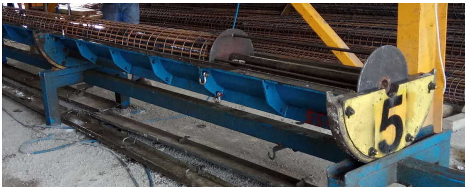
Φωτ. 1 Οπλισμός μέσα στο καλούπι για σκυροδέτηση. Διακρίνεται ο "αποστάτης" για την μείωση του μήκους στύλου σε σχέση με το μήκος
