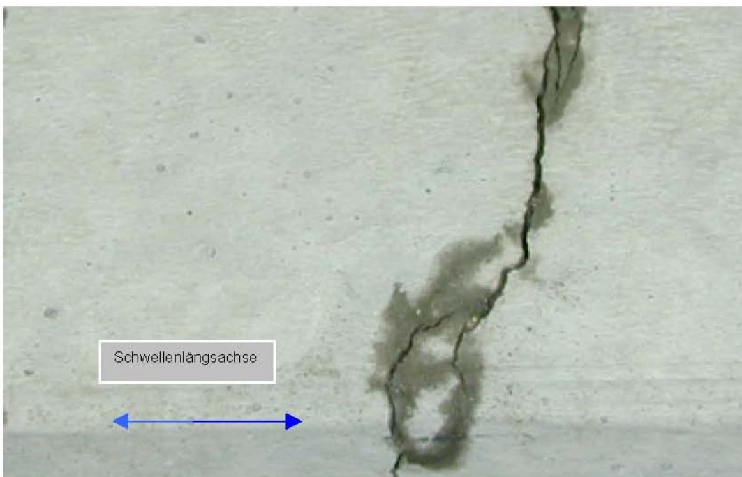
Εικόνα 6 Κεντρικό μέρος στρωτήρα, ανοιχτή ρωγμή, Κατηγορία βλάβης 1 (στο εσωτερικό της εικόνας: διαμήκης άξονας στρωτήρα)
